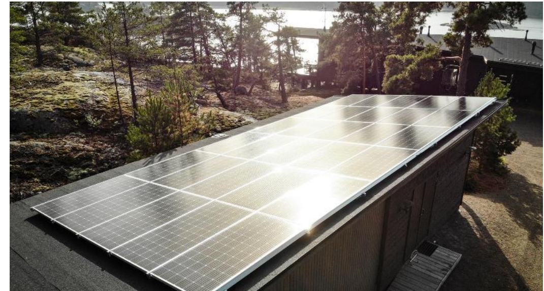
Kuva: Turku Energia, Aurinkopaneelit kotiin
